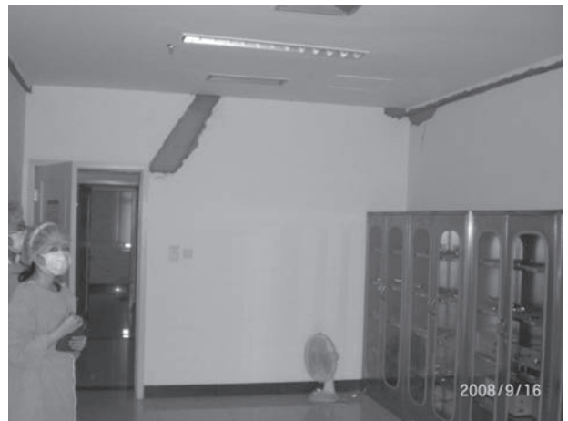
写真2 病院の手術室器材庫。損傷部を補修した痕がある
